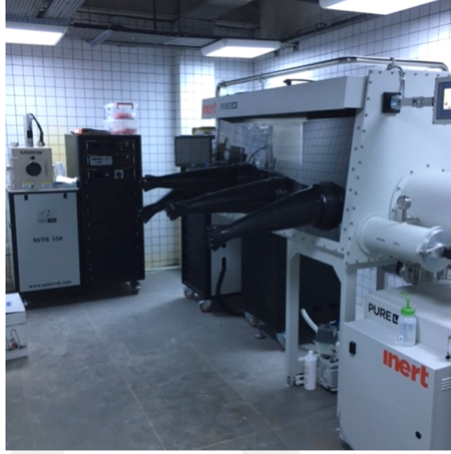
Şekil 97. AGÜ'ye kurulumu gerçekleştirilen Glove Box entegre OLED fabrikasyon sistemi (organik ve metal buharlaştırıcı) ve metal buharlaştırıcı sistemi
